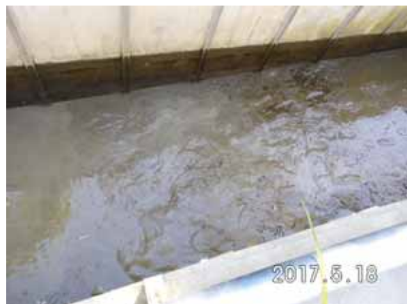
水抜き後の水路に貯まった泥水の様子
