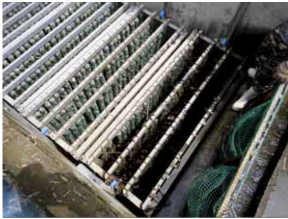
枝葉等の除去・洗浄前のモールコード
