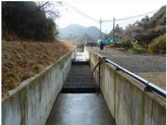
水路に取り付けられたモールコード
