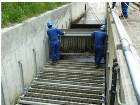
洗浄・天日干し後のモールコードの 水路への設置状況
