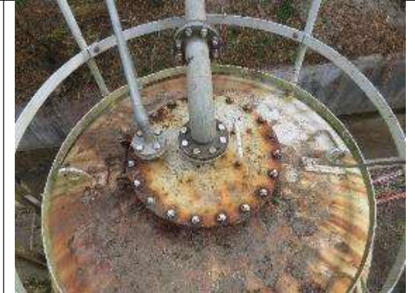
<自動活性ろ過器の天蓋の閉鎖の様子> 2026年1月20日に実施
